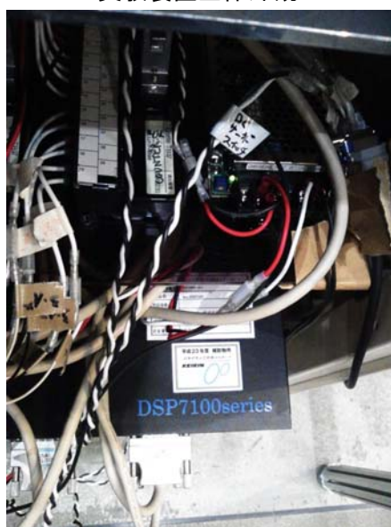
制御装置外観
